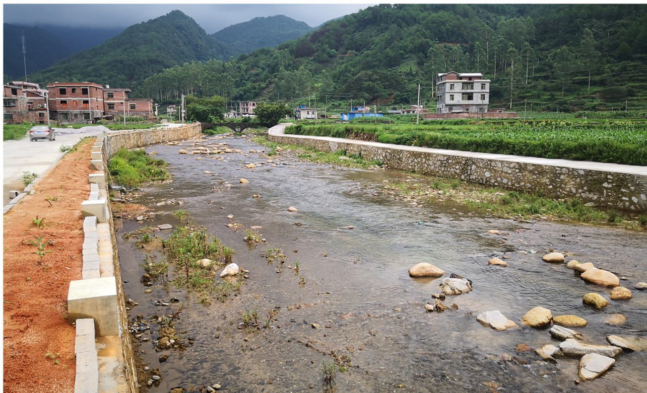
钟山县思勤江两安乡片小流域水土保持综合治理防护堤工程
